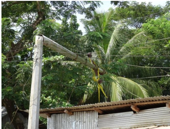
Broken power pole – Hatiya Island Bangladesh (Bertheau, 2014).
