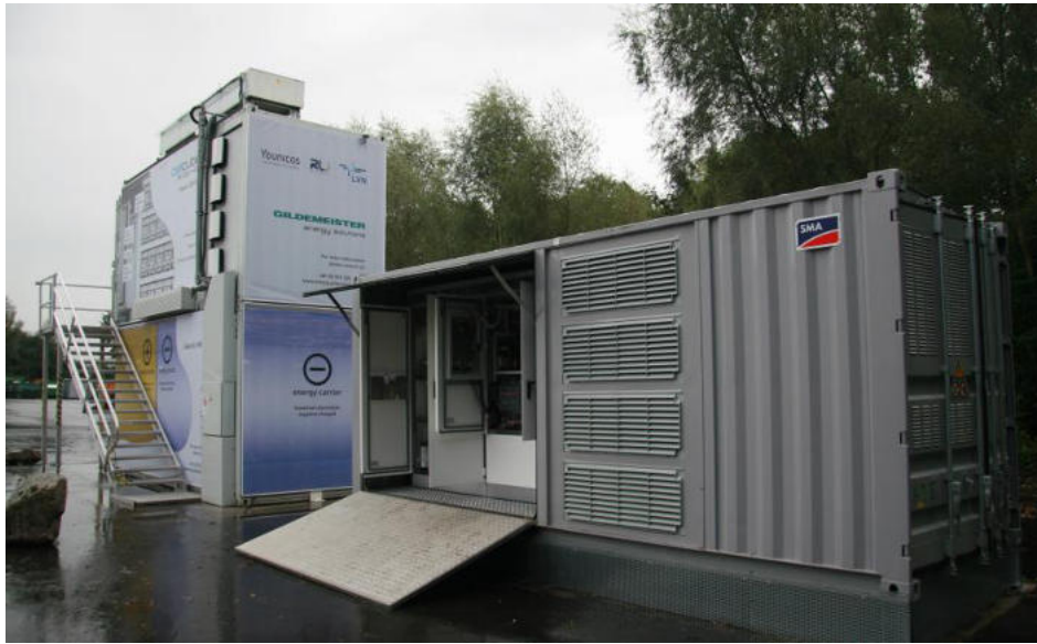
Abbildung 2.22.: Offizielle Einweihung des Speichersystems in Bayern. Im Vordergrund die umgebaute SMA-Containerstation „MVPS - Medium Voltage Power Station“ für den Batteriewechselrichter und im Hintergrund das Redox-Flow-Batteriesystem.
