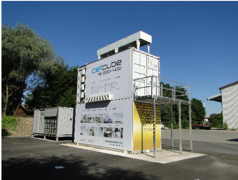
Abbildung 1.2.: Im Projekt SmartPowerFlow installierte Vanadium-Redox-Flow-Batterie.
